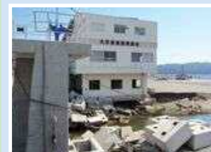
津波で破壊された漁協
